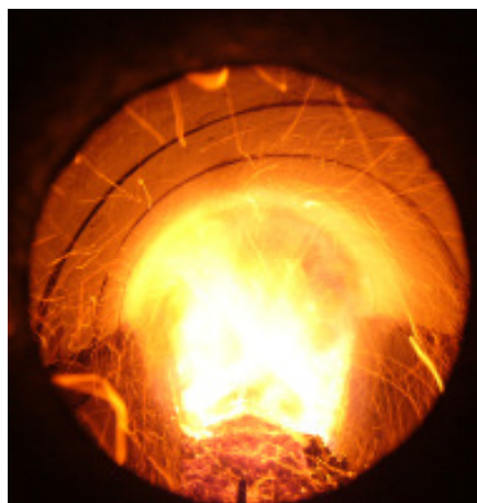
Blick in den Feuerraum
