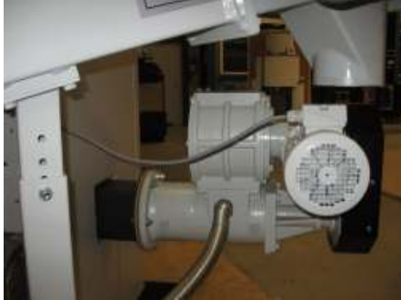
Zellenradschleuse mit Wasserlöscheinrichtung (HDG Bavaria)
